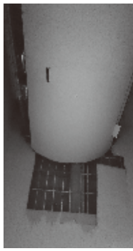
▲ ホワイエの天井部分壁がかなり落下
