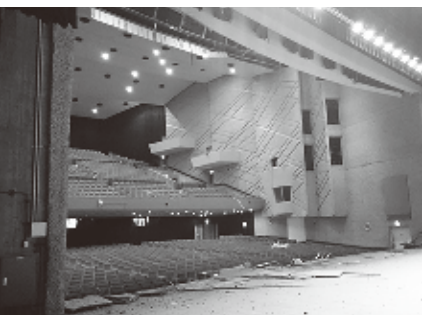
▲ 客席や舞台上に天井部分が落下
