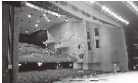
▲ 被災して休館中の熊本市市民会館
